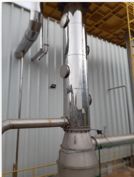
Figura 13. Tubulações para passagem de gases na Unidade em Rifaina.
